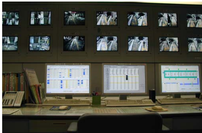
写真-4 運転指令室モニター更新
